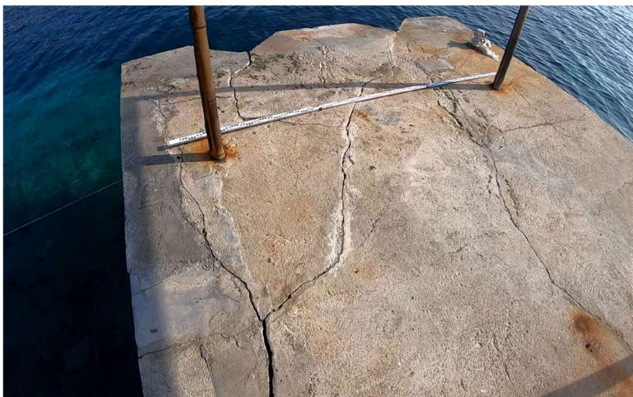
Slika 1.4. Oštećenja na vanjskom gatu – površinska obrada
