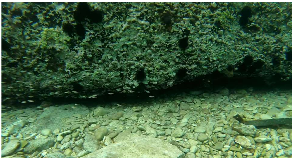
Slika 1.5. Oštećenja na obalnom zidu sunčališta -podlokanje
