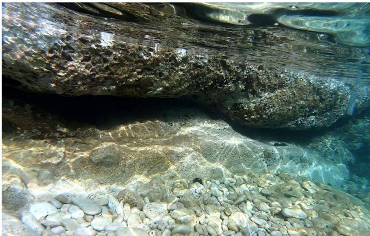
Slika 1.2. Oštećenja na vanjskom gatu – podlokavanje
