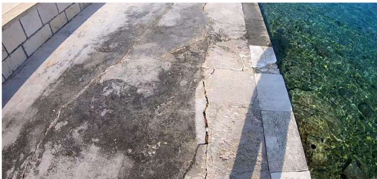
Slika 1.6. Oštećenja površinske obrade sunčališta
