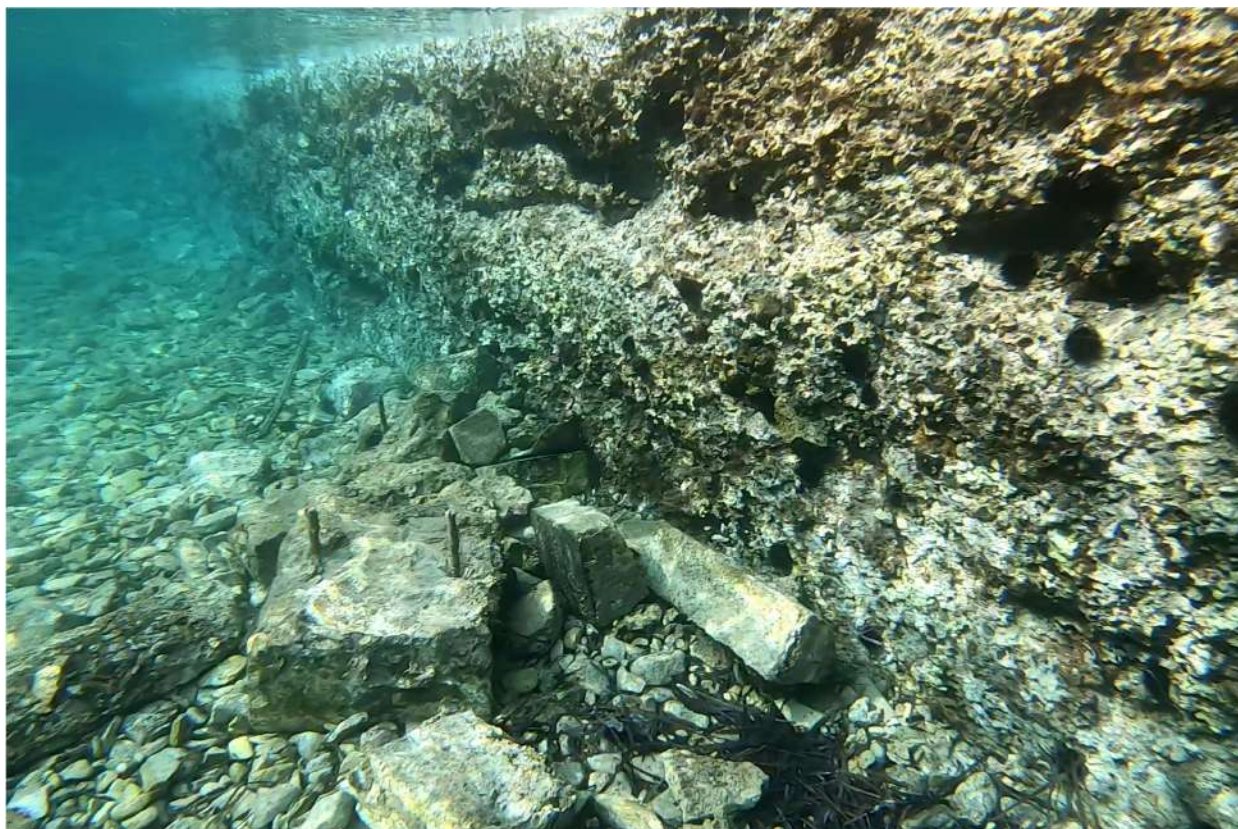
Slika 1.8. Oštećenja na unutrašnjem gatu – podmorski zid
