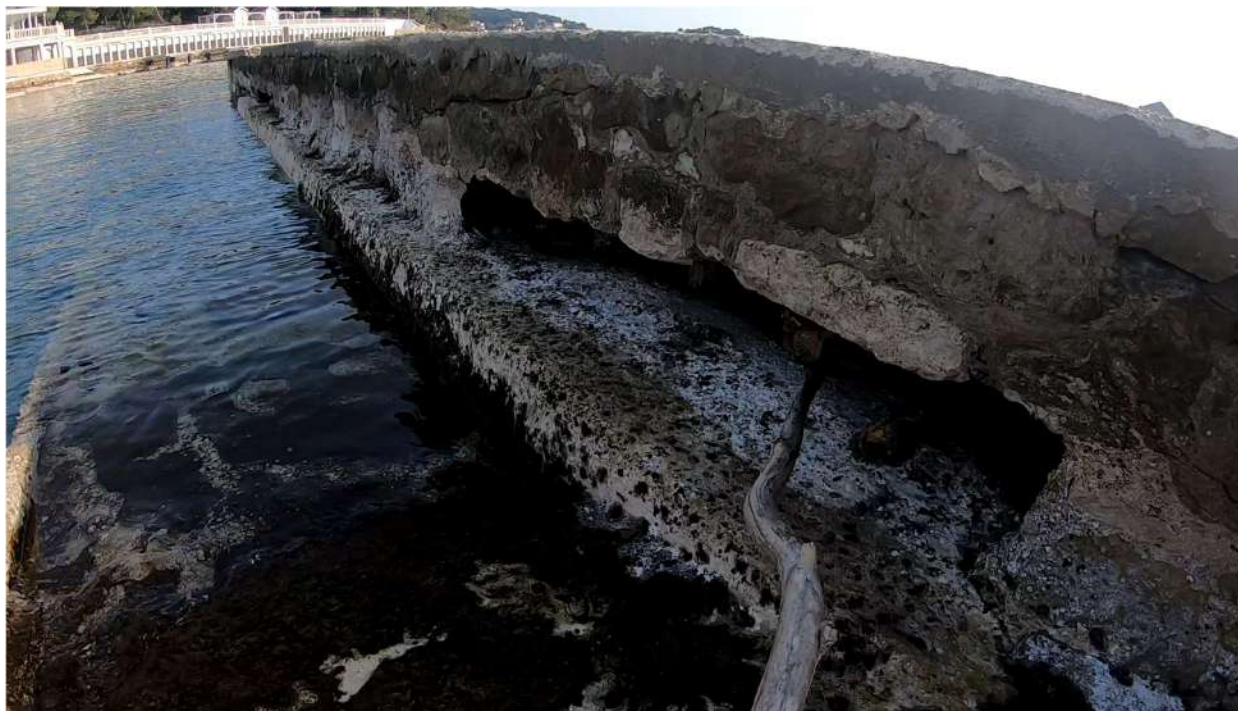
Slika 1.10. Oštećenja na unutrašnjem gatu – unutrašnji nadmorski zid
