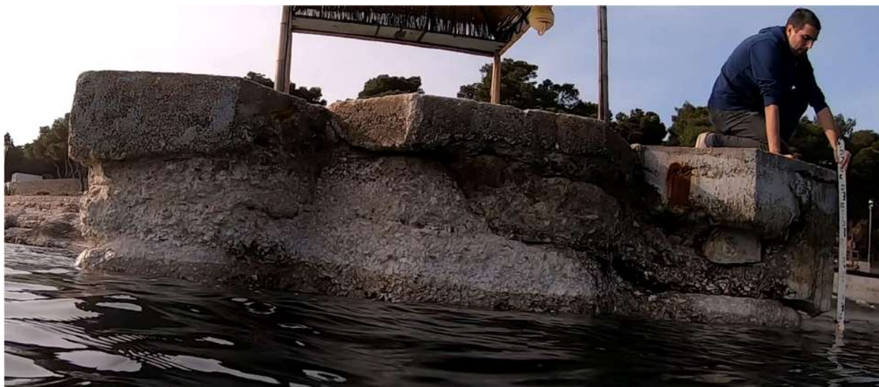
Slika 1.3. Oštećenja na vanjskom gatu – nadmorski zid
