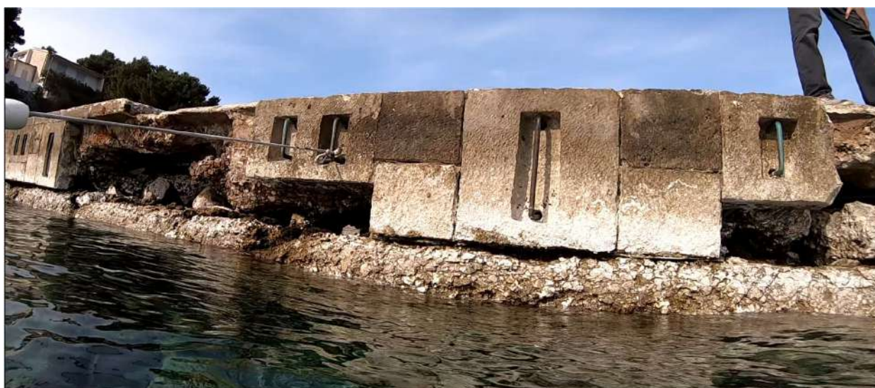
Slika 1.9. Oštećenja na unutrašnjem gatu – vanjski nadmorski zid
