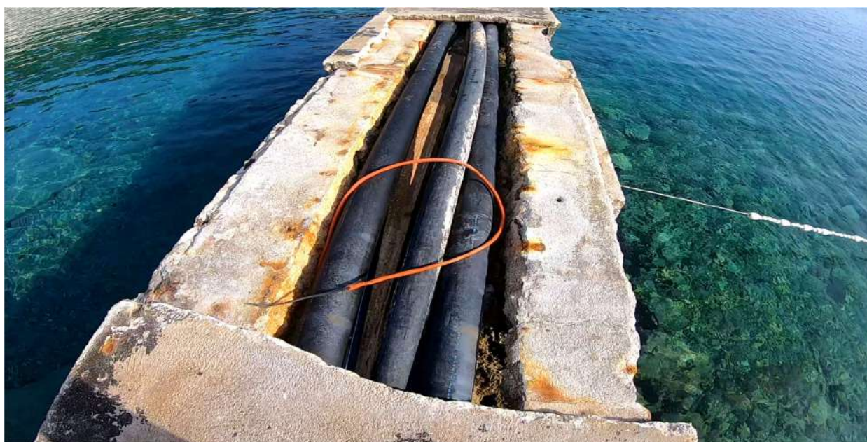
Slika 1.11. Oštećenja na unutrašnjem gatu – površinska obrada
