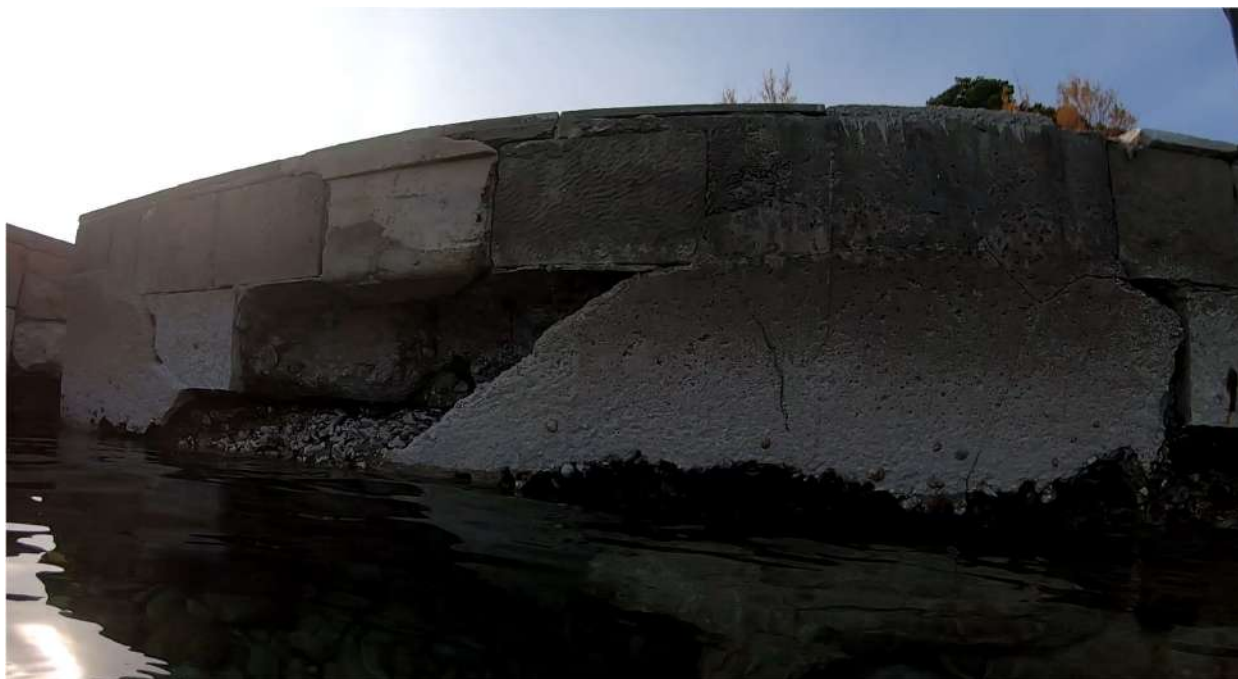
Slika 1.7. Oštećenje obložnice i poklopnice na dijelu obalnog zida sunčališta
