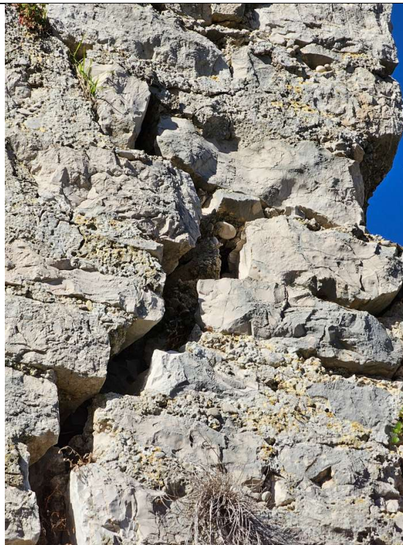
Slika 3-18 Zid – vertikalna pukotina na spoju s istočnim dijelom zidina
