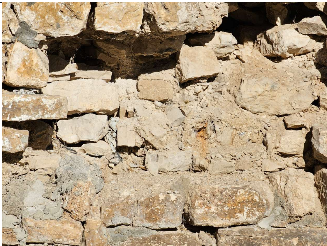
Slika 3-22 Zid – odlamanje i ispadanje kamenih blokova iz strukture zidina
