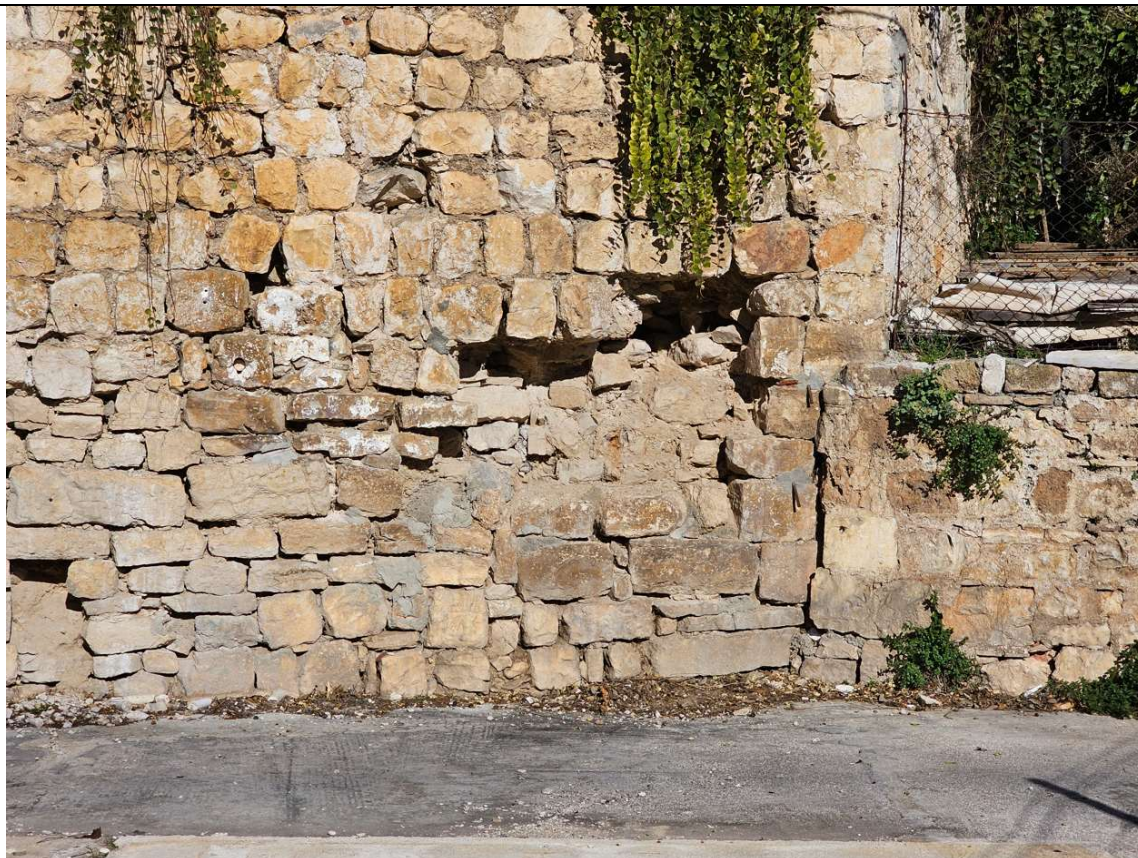
Slika 3-21 Zid – odlamanje i ispadanje kamenih blokova iz strukture zidina
