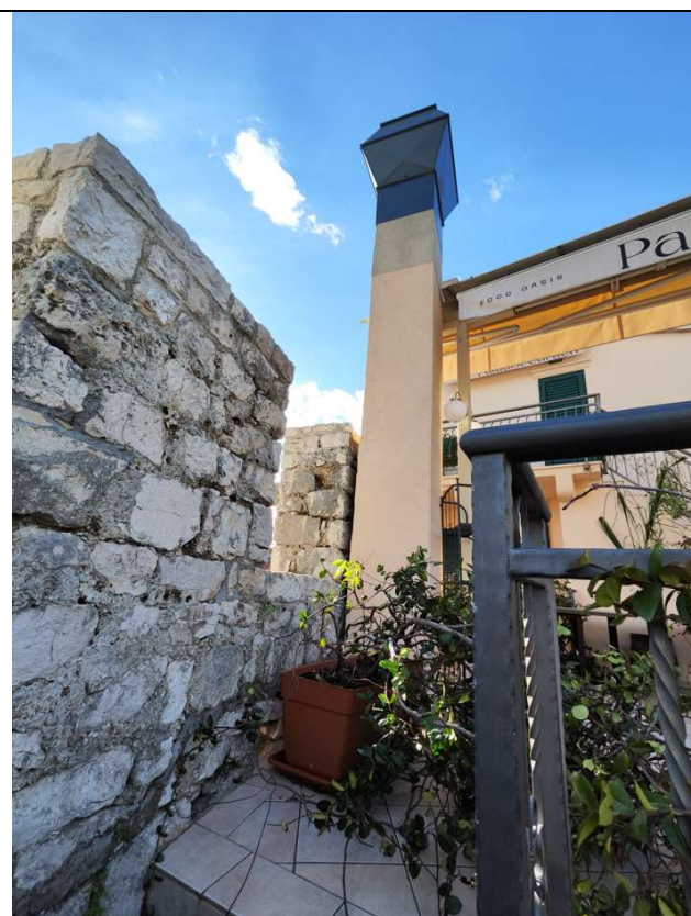
Slika 3-25 Unutarnja strana zidina – neprimjereno izvedene intervencije po ophodu (dimnjak)
