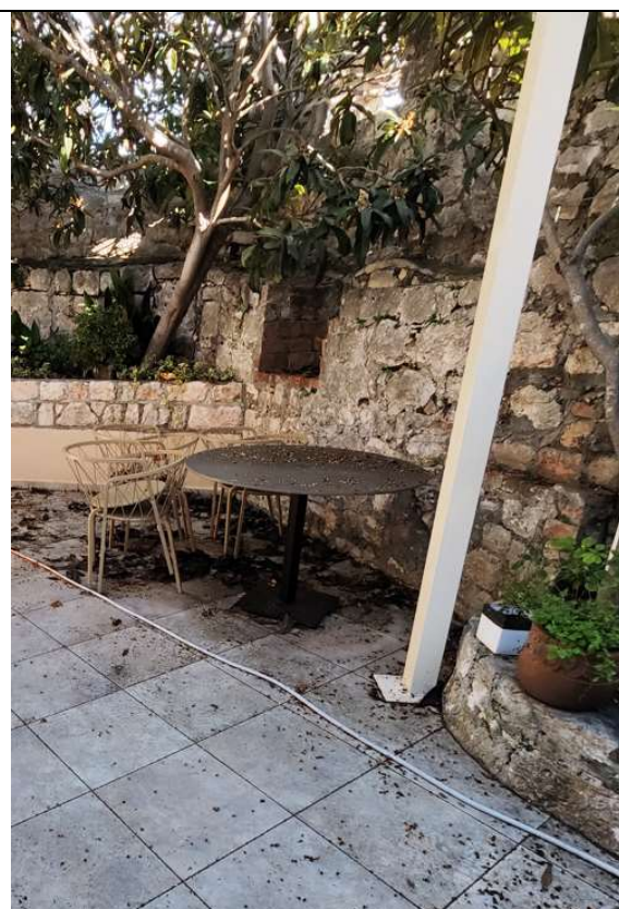
Slika 3-26 Unutarnja strana zidina – neprimjereno izvedene intervencije po ophodu (niša)
