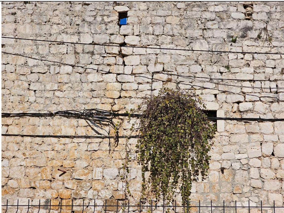
Slika 3-19 Zid – neispunjenost sljubnica i raslinje
